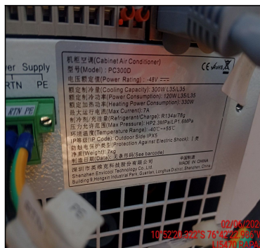
FOTO DE PLACA DE UNIDAD EVAPORADORA
