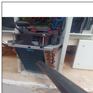
FOTO DE LIMPIEZA Y ESTADO DE SERPENTIN DE UE
