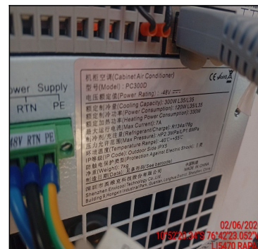
FOTO DE PLACA DE UNIDAD CONDENSADORA
