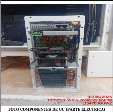
FOTO COMPONENTES DE UC (PARTE ELECTRICA)
