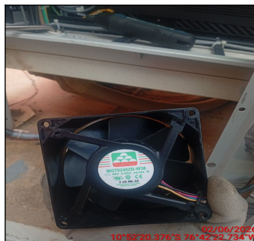
FOTO CORRIENTE REAL EN MOTOR VENTILADOR
