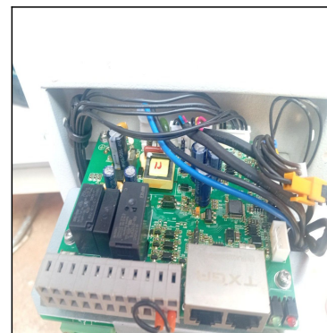
FOTO DE COMPONENTES DE UE (PARTE ELECTRICA)
