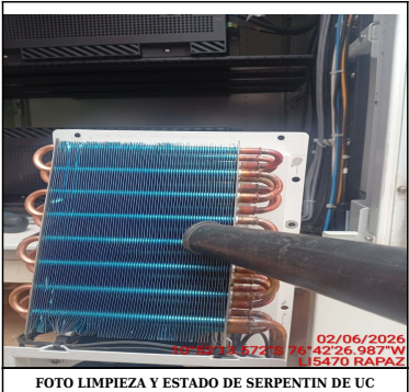
FOTO LIMPIEZA Y ESTADO DE SERPENTIN DE UC
