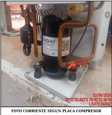
FOTO CORRIENTE SEGUN PLACA COMPRESOR
