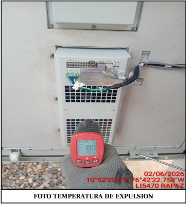
FOTO TEMPERATURA DE EXPULSION
