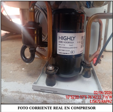
FOTO CORRIENTE REAL EN COMPRESOR
