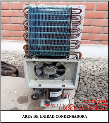
AREA DE UNIDAD CONDENSADORA
