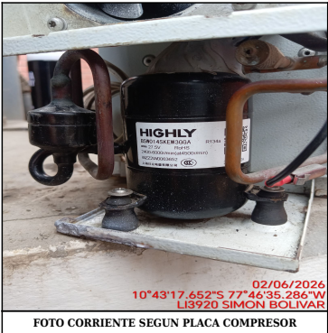
FOTO CORRIENTE SEGUN PLACA COMPRESOR
