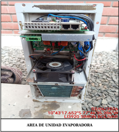
AREA DE UNIDAD EVAPORADORA
