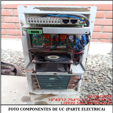
FOTO COMPONENTES DE UC (PARTE ELECTRICA)
