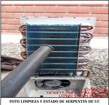
FOTO LIMPIEZA Y ESTADO DE SERPENTIN DE UC
