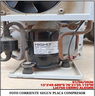
FOTO CORRIENTE SEGUN PLACA COMPRESOR
