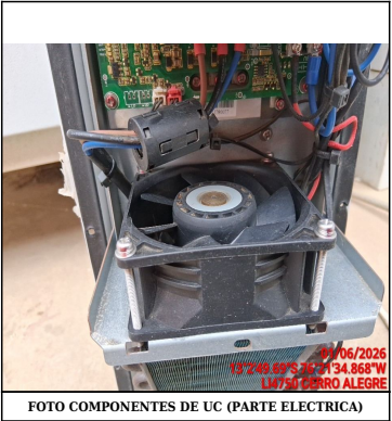
FOTO COMPONENTES DE UC (PARTE ELECTRICA)
