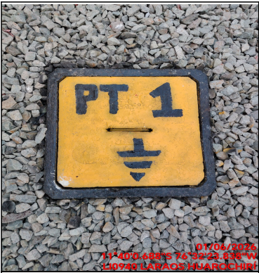
Pozo a tierra
