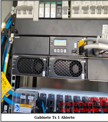
Gabinete Tx 1 Abierto
