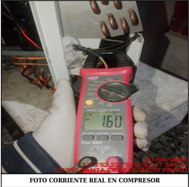
FOTO CORRIENTE REAL EN COMPRESOR
