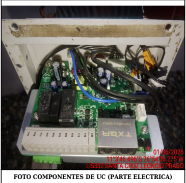
FOTO COMPONENTES DE UC (PARTE ELECTRICA)
