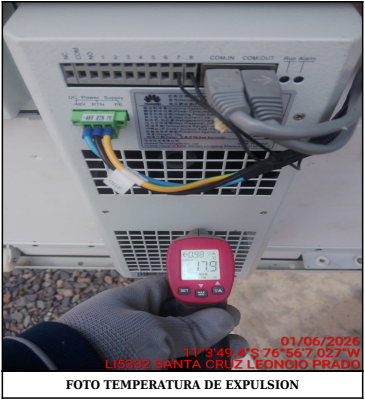
FOTO TEMPERATURA DE EXPULSION
