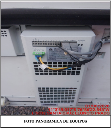
FOTO PANORAMICA DE EQUIPOS
