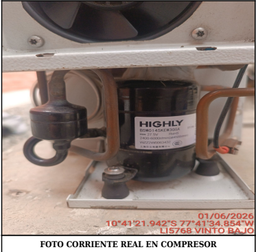
FOTO CORRIENTE REAL EN COMPRESOR
