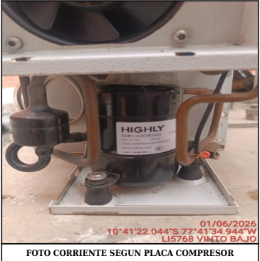
FOTO CORRIENTE SEGUN PLACA COMPRESOR
