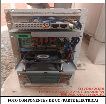
FOTO COMPONENTES DE UC (PARTE ELECTRICA)
