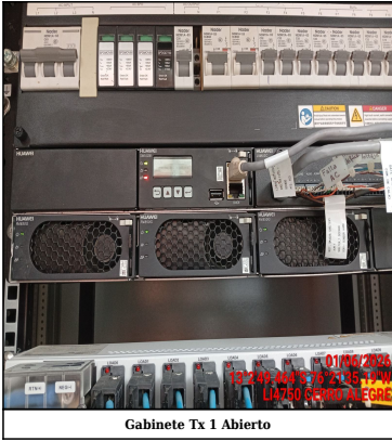
Gabinete Tx 1 Abierto
