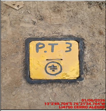
Pozo a tierra
