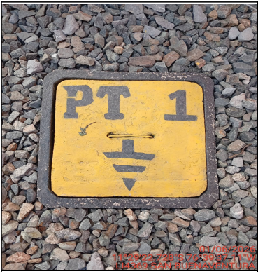
Pozo a tierra
