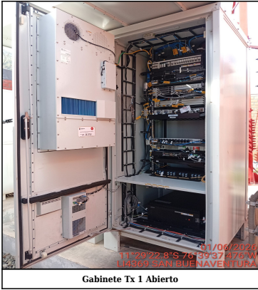
Gabinete Tx 1 Abierto
