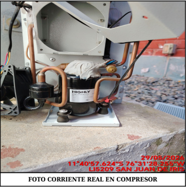
FOTO CORRIENTE REAL EN COMPRESOR
