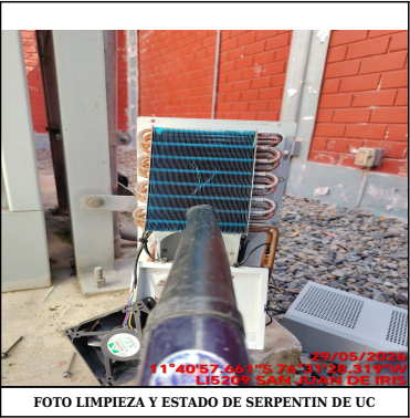
FOTO LIMPIEZA Y ESTADO DE SERPENTIN DE UC
