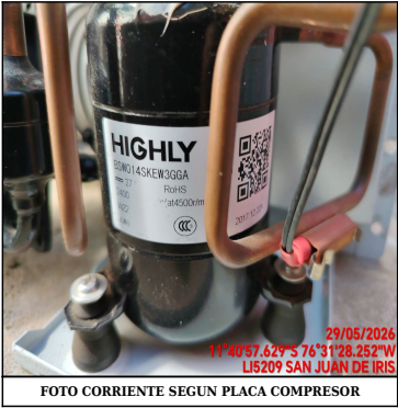
FOTO CORRIENTE SEGUN PLACA COMPRESOR
