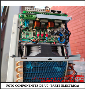
FOTO COMPONENTES DE UC (PARTE ELECTRICA)
