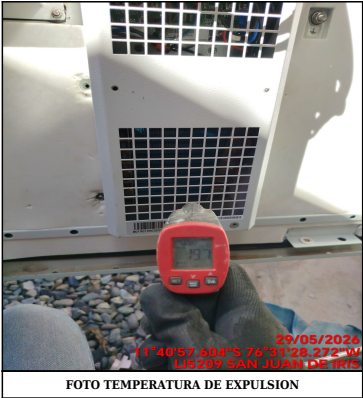
FOTO TEMPERATURA DE EXPULSION
