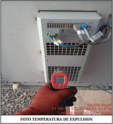
FOTO TEMPERATURA DE EXPULSION
