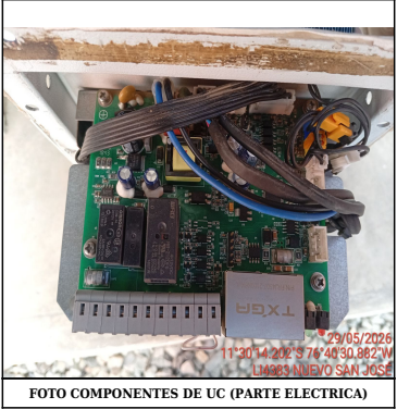
FOTO COMPONENTES DE UC (PARTE ELECTRICA)
