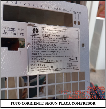
FOTO CORRIENTE SEGUN PLACA COMPRESOR
