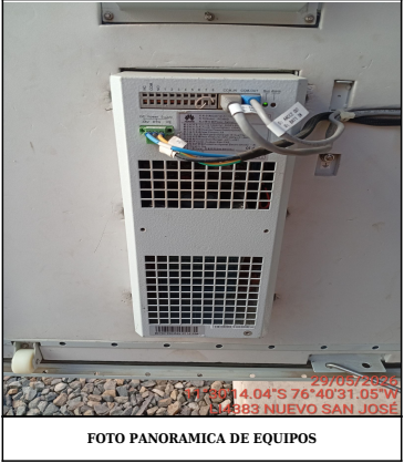
FOTO PANORAMICA DE EQUIPOS
