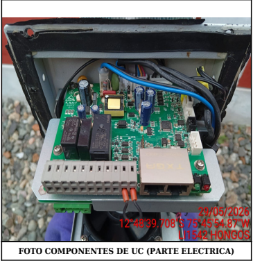
FOTO COMPONENTES DE UC (PARTE ELECTRICA)
