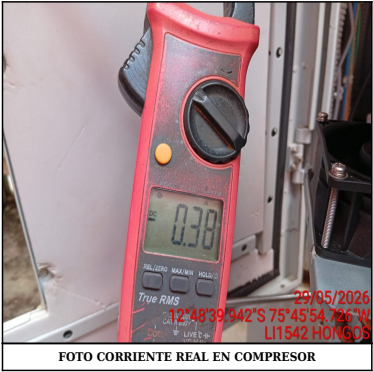
FOTO CORRIENTE REAL EN COMPRESOR
