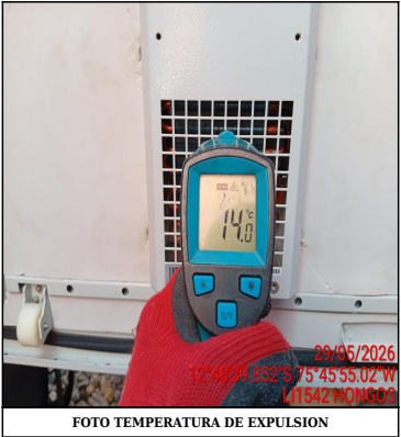
FOTO TEMPERATURA DE EXPULSION
