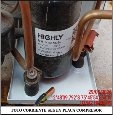
FOTO CORRIENTE SEGUN PLACA COMPRESOR
