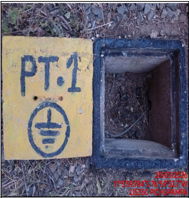
Pozo a tierra
