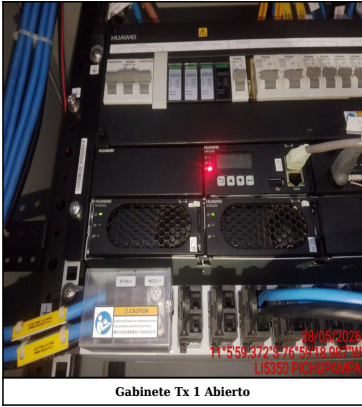
Gabinete Tx 1 Abierto
