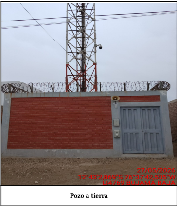
Pozo a tierra
