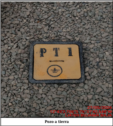
Pozo a tierra
