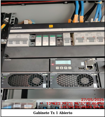
Gabinete Tx 1 Abierto
