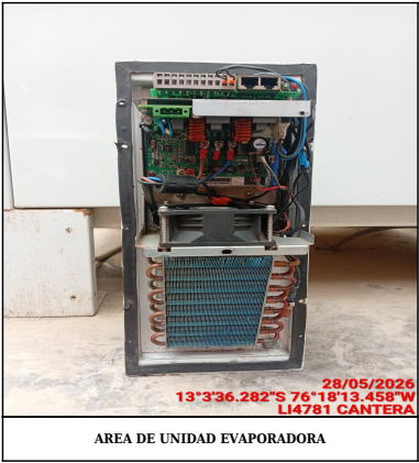
AREA DE UNIDAD EVAPORADORA
