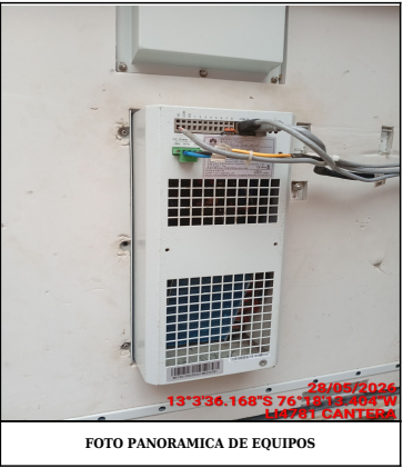
FOTO PANORAMICA DE EQUIPOS
