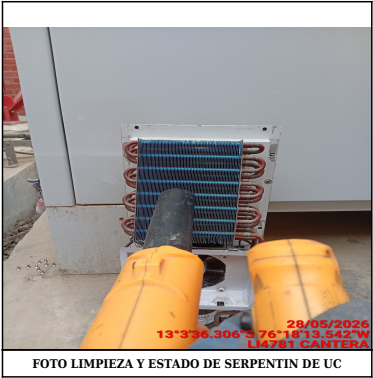
FOTO LIMPIEZA Y ESTADO DE SERPENTIN DE UC
