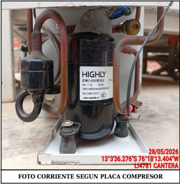
FOTO CORRIENTE SEGUN PLACA COMPRESOR
