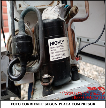
FOTO CORRIENTE SEGUN PLACA COMPRESOR
