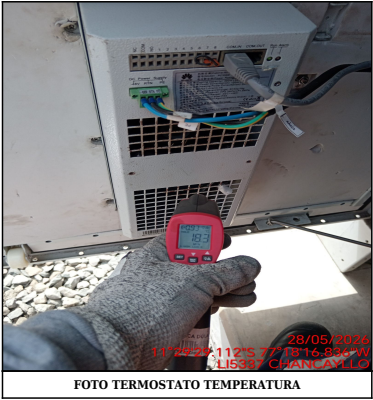
FOTO TERMOSTATO TEMPERATURA
