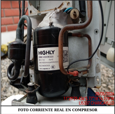
FOTO CORRIENTE REAL EN COMPRESOR
