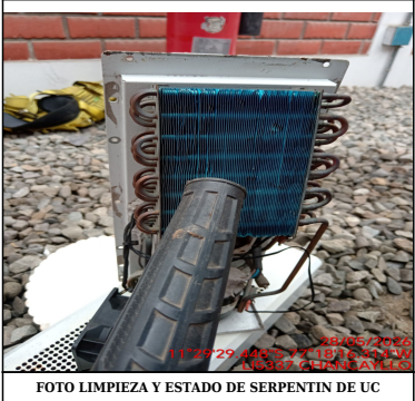
FOTO LIMPIEZA Y ESTADO DE SERPENTIN DE UC
