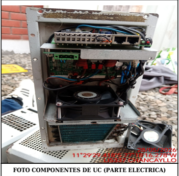
FOTO COMPONENTES DE UC (PARTE ELECTRICA)
