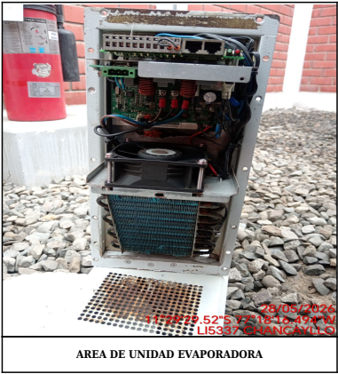
AREA DE UNIDAD EVAPORADORA
