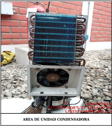
AREA DE UNIDAD CONDENSADORA
