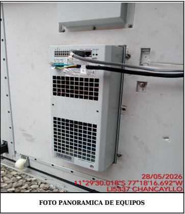
FOTO PANORAMICA DE EQUIPOS
