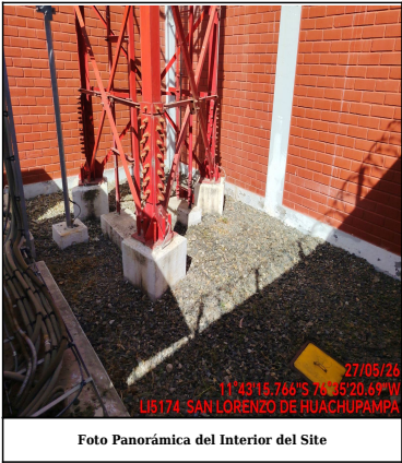
Foto Panorámica del Interior del Site
