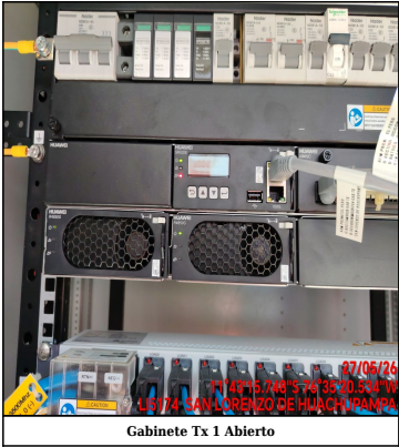
Gabinete Tx 1 Abierto
