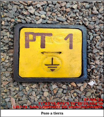
Pozo a tierra
