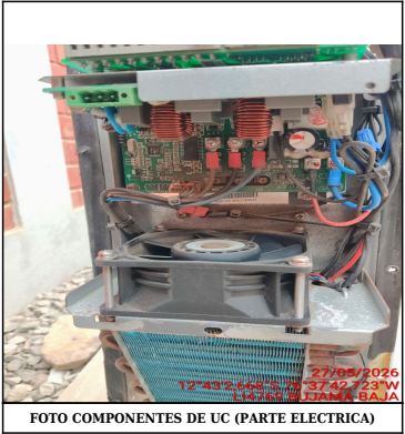
FOTO COMPONENTES DE UC (PARTE ELECTRICA)
