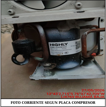
FOTO CORRIENTE SEGUN PLACA COMPRESOR
