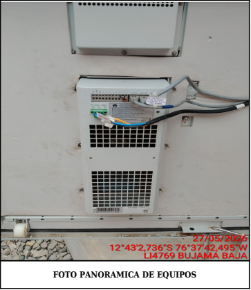
FOTO PANORAMICA DE EQUIPOS
