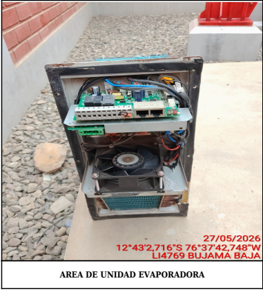
AREA DE UNIDAD EVAPORADORA
