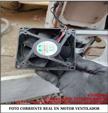
FOTO CORRIENTE REAL EN MOTOR VENTILADOR
