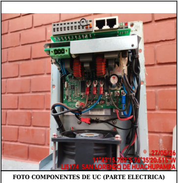
FOTO COMPONENTES DE UC (PARTE ELECTRICA)
