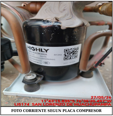
FOTO CORRIENTE SEGUN PLACA COMPRESOR
