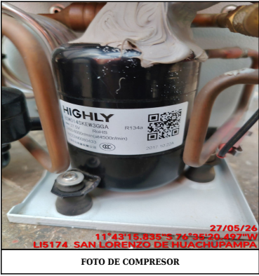
FOTO DE COMPRESOR
