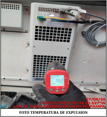
FOTO TEMPERATURA DE EXPULSION
