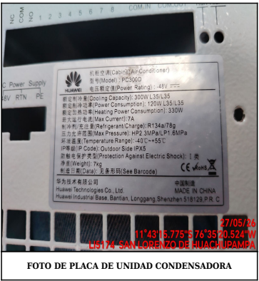
FOTO DE PLACA DE UNIDAD CONDENSADORA
