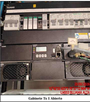
Gabinete Tx 1 Abierto
