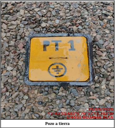
Pozo a tierra
