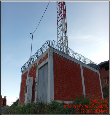
Pozo a tierra
