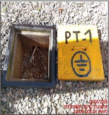
Pozo a tierra
