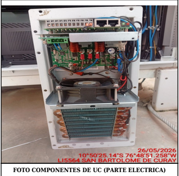
FOTO COMPONENTES DE UC (PARTE ELECTRICA)
