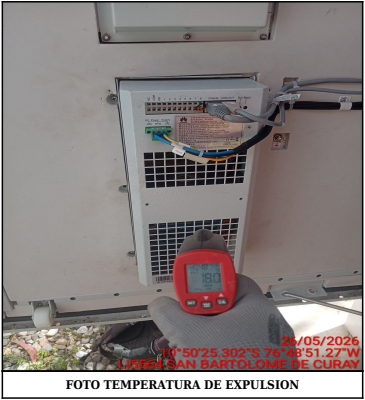
FOTO TEMPERATURA DE EXPULSION
