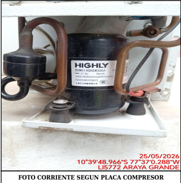
FOTO CORRIENTE SEGUN PLACA COMPRESOR
