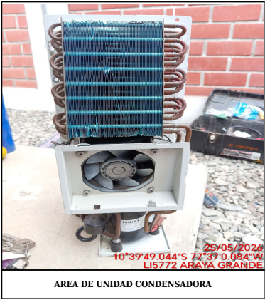
AREA DE UNIDAD CONDENSADORA
