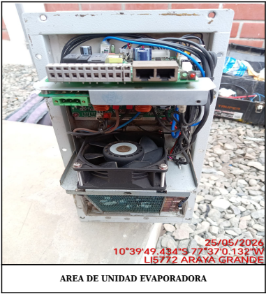
AREA DE UNIDAD EVAPORADORA
