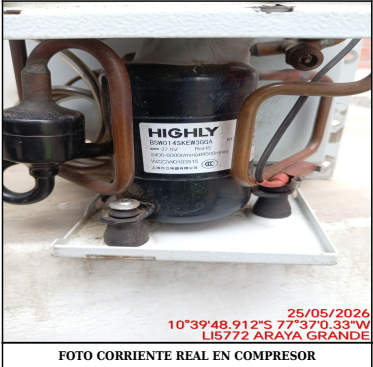
FOTO CORRIENTE REAL EN COMPRESOR
