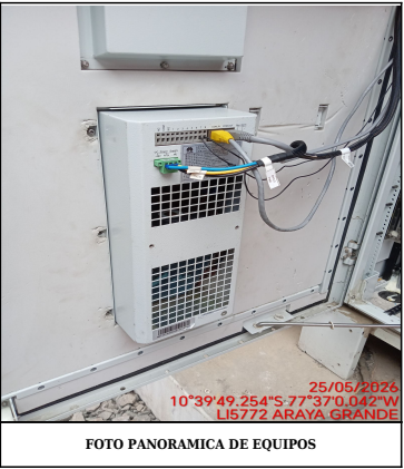
FOTO PANORAMICA DE EQUIPOS
