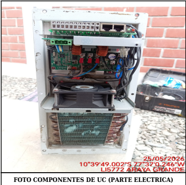
FOTO COMPONENTES DE UC (PARTE ELECTRICA)
