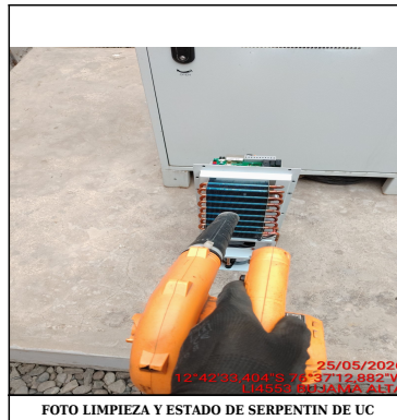
FOTO LIMPIEZA Y ESTADO DE SERPENTIN DE UC
