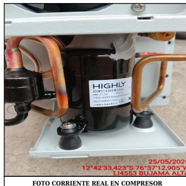
FOTO CORRIENTE REAL EN COMPRESOR
