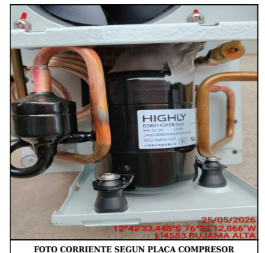
FOTO CORRIENTE SEGUN PLACA COMPRESOR
