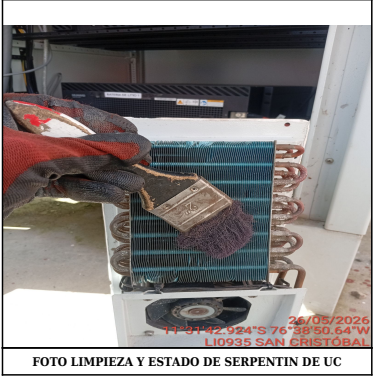
FOTO LIMPIEZA Y ESTADO DE SERPENTIN DE UC
