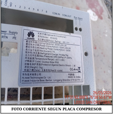
FOTO CORRIENTE SEGUN PLACA COMPRESOR
