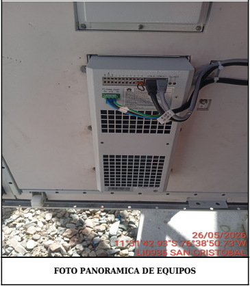
FOTO PANORAMICA DE EQUIPOS
