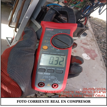
FOTO CORRIENTE REAL EN COMPRESOR
