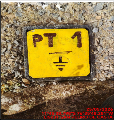
Pozo a tierra
