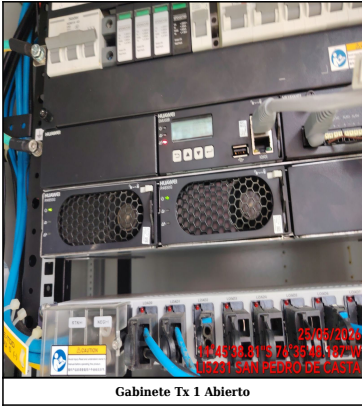
Gabinete Tx 1 Abierto
