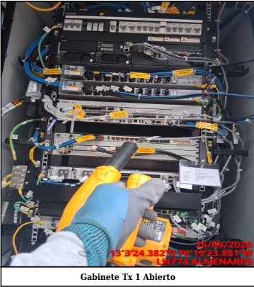
Gabinete Tx 1 Abierto
