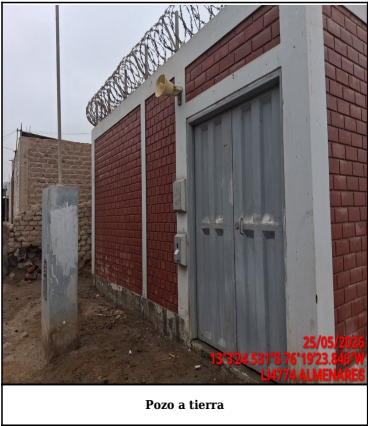
Pozo a tierra
