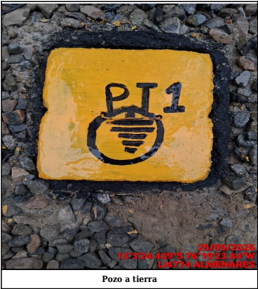
Pozo a tierra
