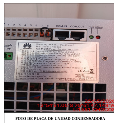
FOTO DE PLACA DE UNIDAD CONDENSADORA
