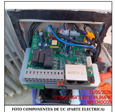
FOTO COMPONENTES DE UC (PARTE ELECTRICA)
