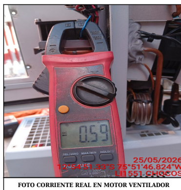
FOTO CORRIENTE REAL EN MOTOR VENTILADOR
