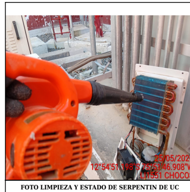
FOTO LIMPIEZA Y ESTADO DE SERPENTIN DE UC
