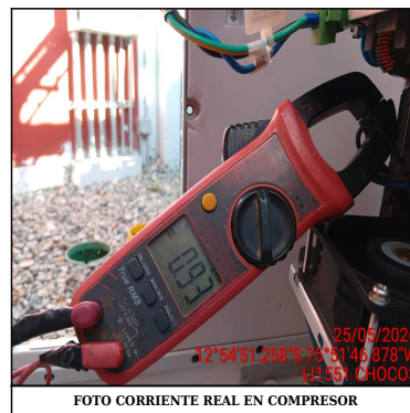
FOTO CORRIENTE REAL EN COMPRESOR
