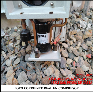
FOTO CORRIENTE REAL EN COMPRESOR
