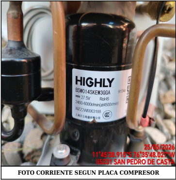
FOTO CORRIENTE SEGUN PLACA COMPRESOR
