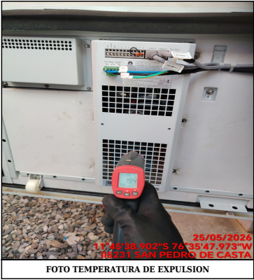
FOTO TEMPERATURA DE EXPULSION
