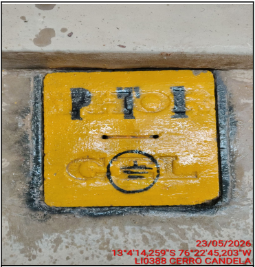
Pozo a tierra
