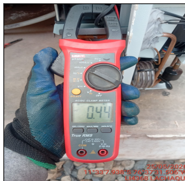
FOTO CORRIENTE REAL EN MOTOR VENTILADOR
