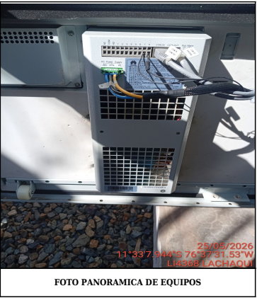
FOTO PANORAMICA DE EQUIPOS
