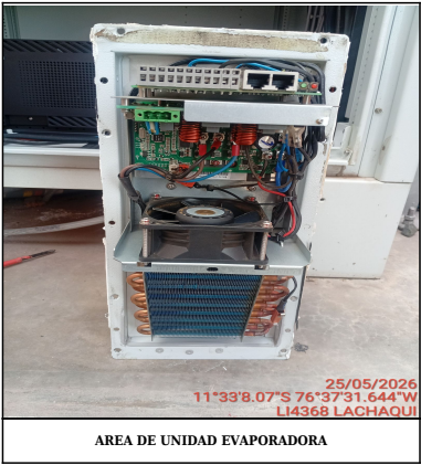
AREA DE UNIDAD EVAPORADORA
