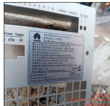
FOTO DE PLACA DE UNIDAD CONDENSADORA
