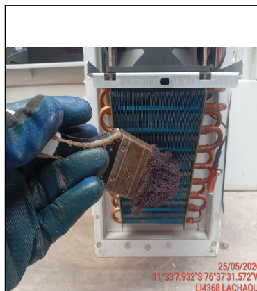
FOTO DE LIMPIEZA Y ESTADO DE SERPENTIN DE U
