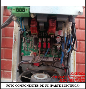
FOTO COMPONENTES DE UC (PARTE ELECTRICA)
