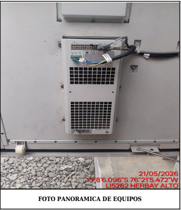
FOTO PANORAMICA DE EQUIPOS
