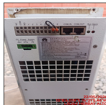
FOTO CORRIENTE SEGUN PLACA EN MOTOR VENTILADOR
