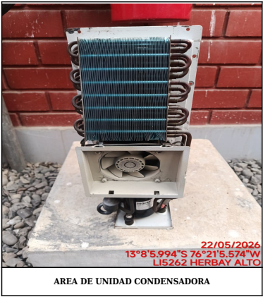
AREA DE UNIDAD CONDENSADORA
