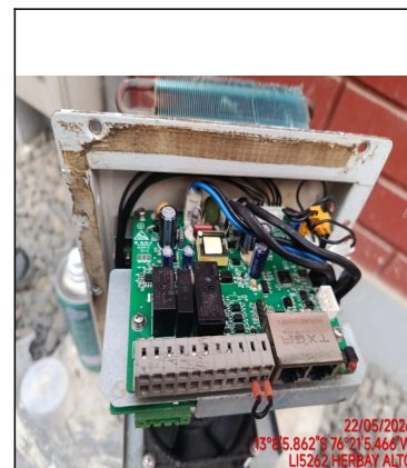
FOTO DE COMPONENTES DE UE (PARTE ELECTRICA)
