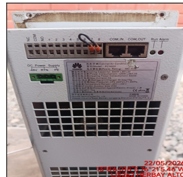
FOTO DE PLACA DE UNIDAD CONDENSADORA
