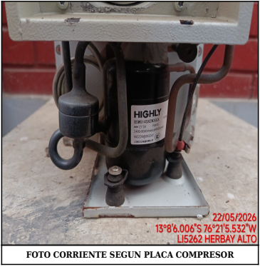
FOTO CORRIENTE SEGUN PLACA COMPRESOR
