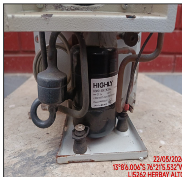
FOTO DE COMPRESOR
