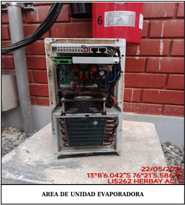
AREA DE UNIDAD EVAPORADORA
