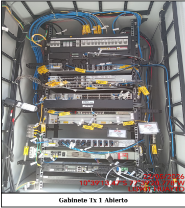
Gabinete Tx 1 Abierto
