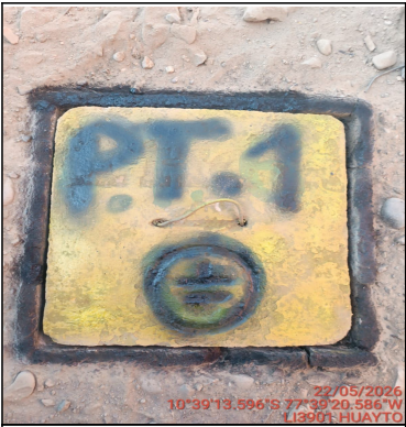
Pozo a tierra
