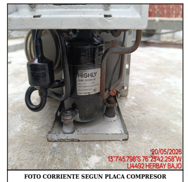
FOTO CORRIENTE SEGUN PLACA COMPRESOR
