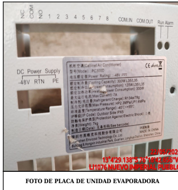
FOTO DE PLACA DE UNIDAD EVAPORADORA
