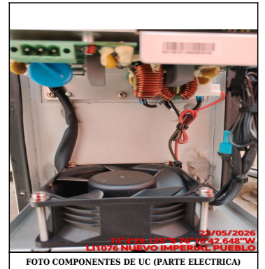
FOTO COMPONENTES DE UC (PARTE ELECTRICA)
