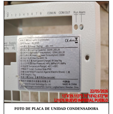
FOTO DE PLACA DE UNIDAD CONDENSADORA
