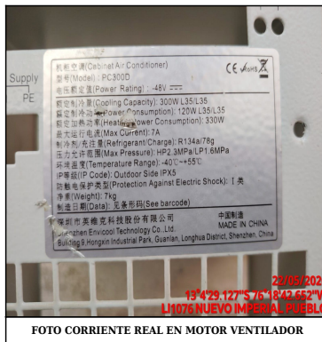
FOTO CORRIENTE REAL EN MOTOR VENTILADOR
