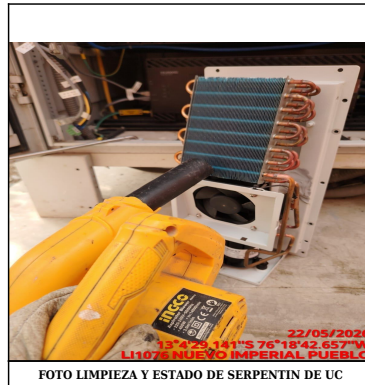
FOTO LIMPIEZA Y ESTADO DE SERPENTIN DE UC
