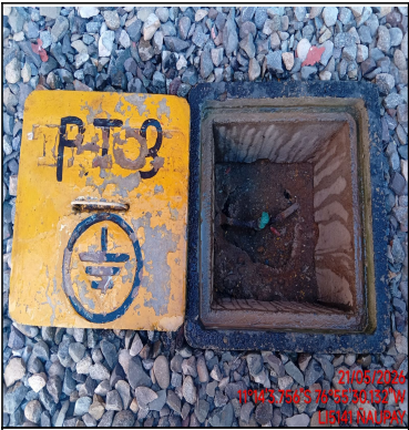
Pozo a tierra
