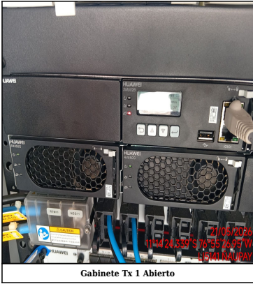
Gabinete Tx 1 Abierto
