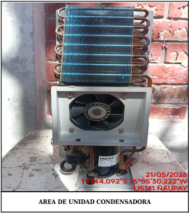
AREA DE UNIDAD CONDENSADORA
