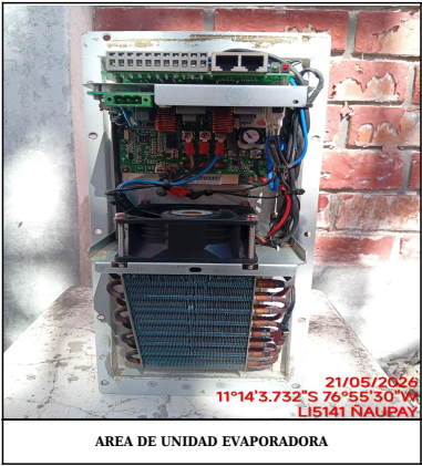
AREA DE UNIDAD EVAPORADORA
