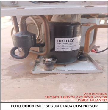
FOTO CORRIENTE SEGUN PLACA COMPRESOR
