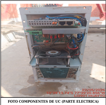
FOTO COMPONENTES DE UC (PARTE ELECTRICA)
