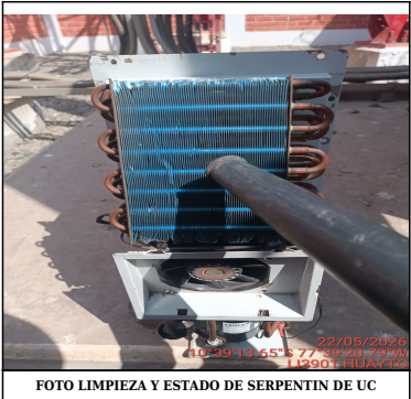
FOTO LIMPIEZA Y ESTADO DE SERPENTIN DE UC
