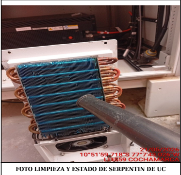
FOTO LIMPIEZA Y ESTADO DE SERPENTIN DE UC
