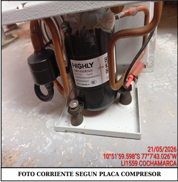
FOTO CORRIENTE SEGUN PLACA COMPRESOR
