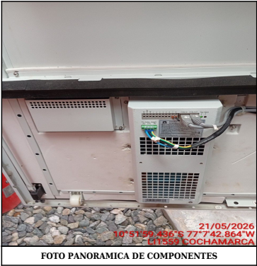
FOTO PANORAMICA DE COMPONENTES
