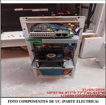
FOTO COMPONENTES DE UC (PARTE ELECTRICA)
