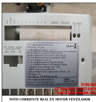
FOTO CORRIENTE REAL EN MOTOR VENTILADOR
