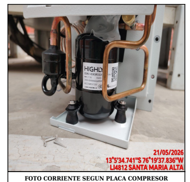
FOTO CORRIENTE SEGUN PLACA COMPRESOR
