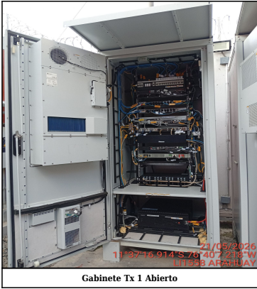
Gabinete Tx 1 Abierto
