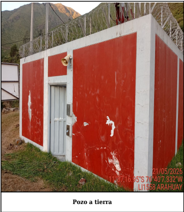
Pozo a tierra
