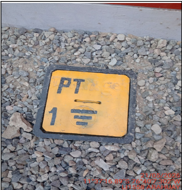
Pozo a tierra
