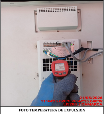
FOTO TEMPERATURA DE EXPULSION
