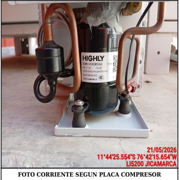
FOTO CORRIENTE SEGUN PLACA COMPRESOR
