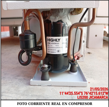
FOTO CORRIENTE REAL EN COMPRESOR
