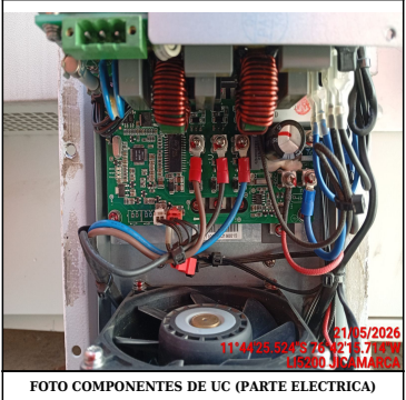
FOTO COMPONENTES DE UC (PARTE ELECTRICA)
