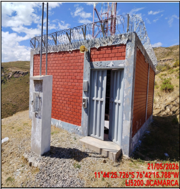
Pozo a tierra
