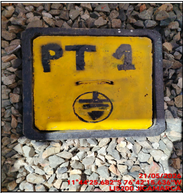
Pozo a tierra
