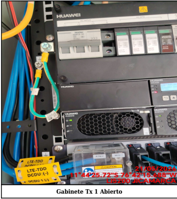
Gabinete Tx 1 Abierto
