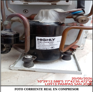
FOTO CORRIENTE REAL EN COMPRESOR
