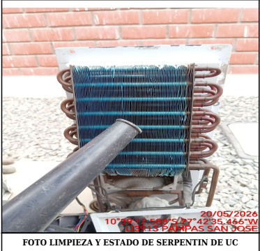
FOTO LIMPIEZA Y ESTADO DE SERPENTIN DE UC
