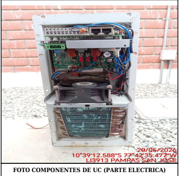
FOTO COMPONENTES DE UC (PARTE ELECTRICA)
