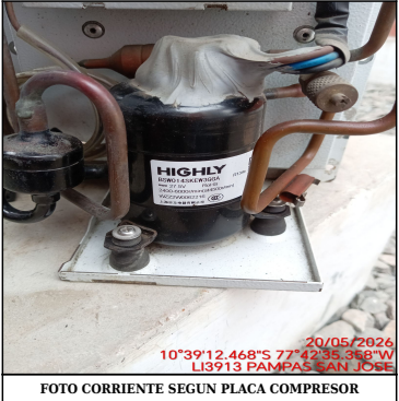
FOTO CORRIENTE SEGUN PLACA COMPRESOR
