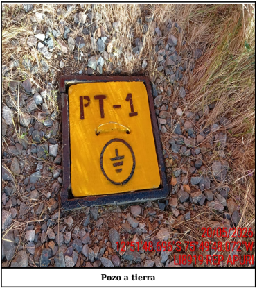
Pozo a tierra
