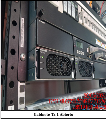
Gabinete Tx 1 Abierto
