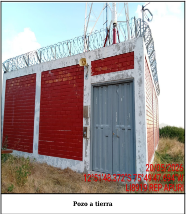
Pozo a tierra
