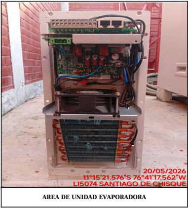
AREA DE UNIDAD EVAPORADORA
