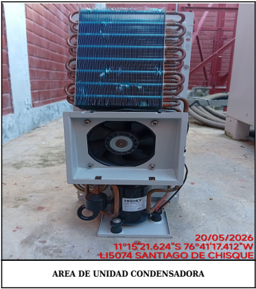
AREA DE UNIDAD CONDENSADORA
