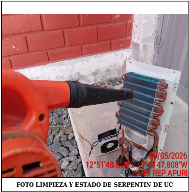
FOTO LIMPIEZA Y ESTADO DE SERPENTIN DE UC
