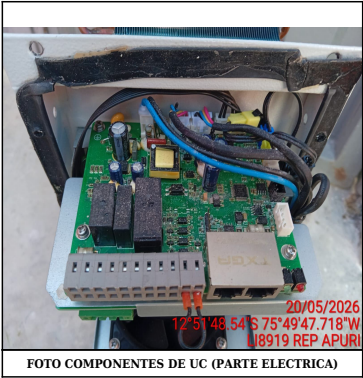
FOTO COMPONENTES DE UC (PARTE ELECTRICA)
