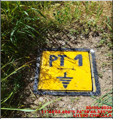
Pozo a tierra
