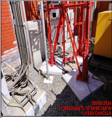
Foto Panorámica del Interior del Site
