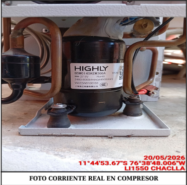
FOTO CORRIENTE REAL EN COMPRESOR
