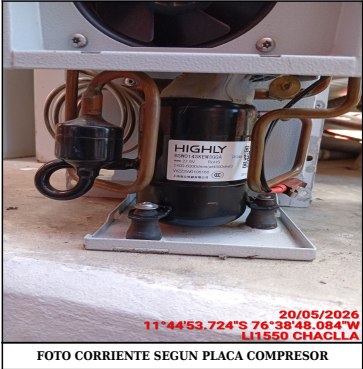
FOTO CORRIENTE SEGUN PLACA COMPRESOR
