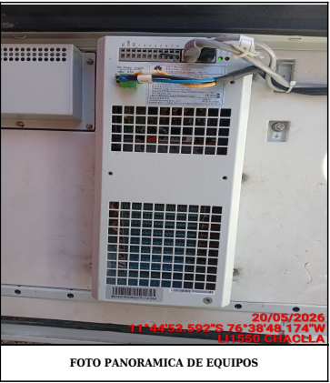
FOTO PANORAMICA DE EQUIPOS
