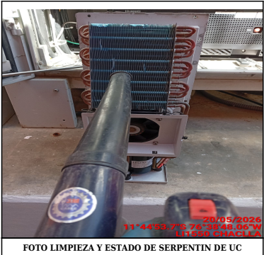
FOTO LIMPIEZA Y ESTADO DE SERPENTIN DE UC
