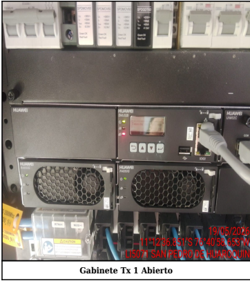
Gabinete Tx 1 Abierto
