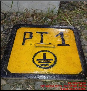
Pozo a tierra
