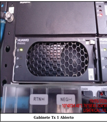
Gabinete Tx 1 Abierto
